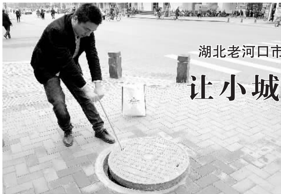
老河口市工作人员正在做智能井盖报警测试，井盖上的触发器可自动发送报警信号至智慧城市平台。
