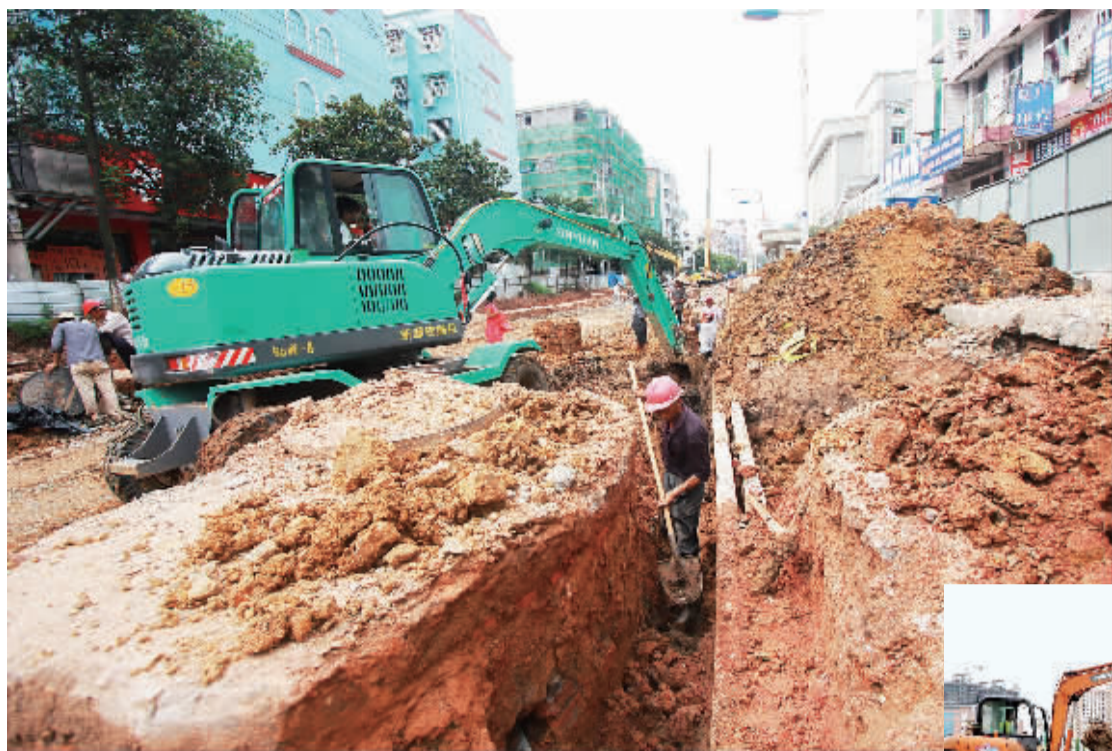
上图 江西省广昌县为进一步改善城市防洪排水功能,筹资9000余万元实施地下排水管网建设,以提升城市排水及防汛能力。图为广昌县城主干道改造施工现场,工人们正在开挖排水沟渠,以埋设地下排水管道。
