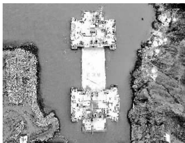
7月13日,港珠澳大桥管理局发布消息称,港珠澳大桥海底隧道建设再下一城,直线段隧道的最后一段管节——E28沉管安装成功,隧道总长达4860米,对接误差仅3毫米。图为E28沉管被运往安装现场。(新华社发)
