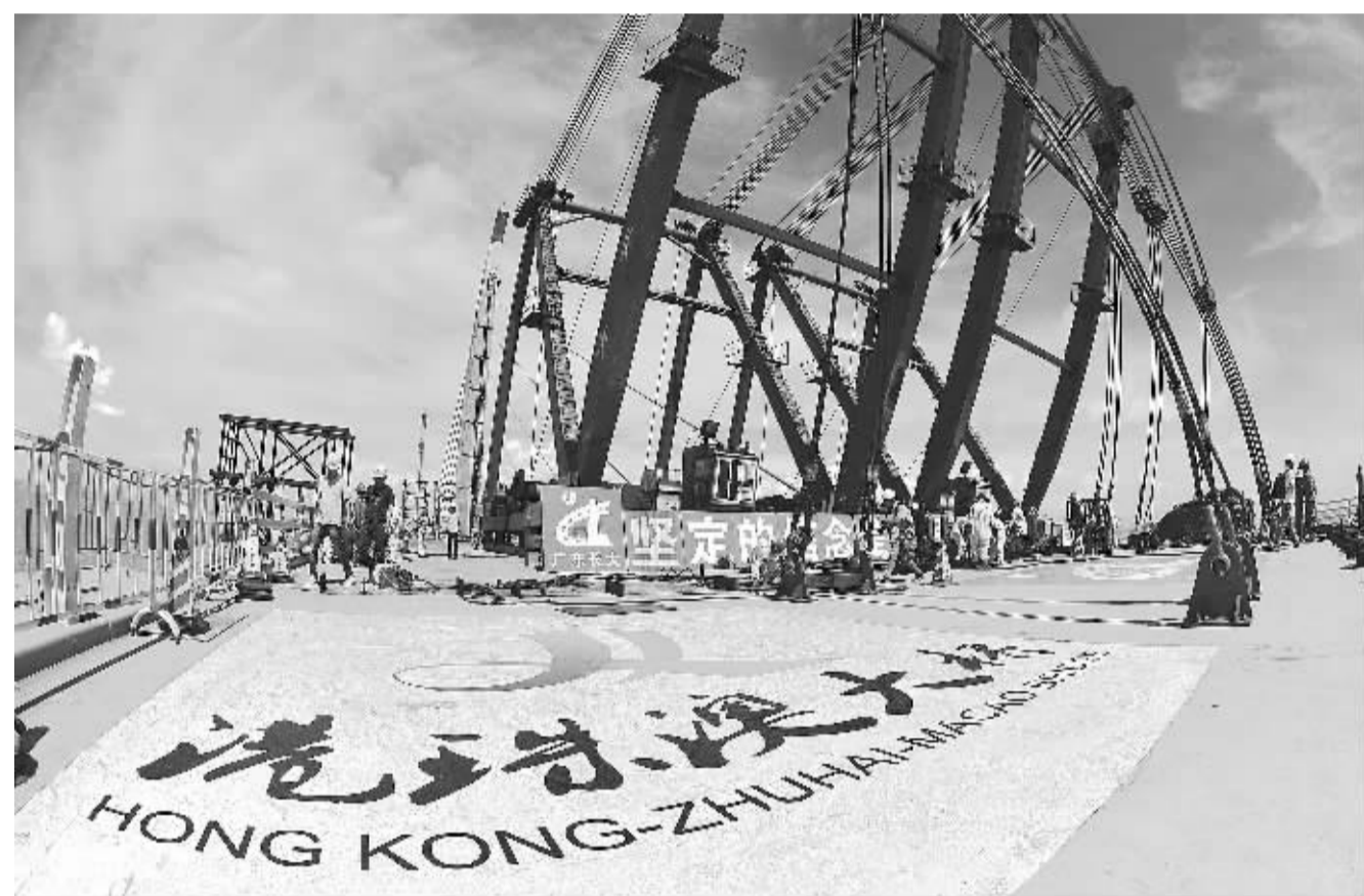
6月29日,港珠澳大桥主体桥梁合龙仪式在珠海举行。港珠澳大桥主体建设工程于2009年12月15日开工建设。本次合龙的主体桥梁工程包括3座通航孔桥及深、浅水区非通航孔桥。图为港珠澳大桥主体桥梁合龙现场。(新华社发)
