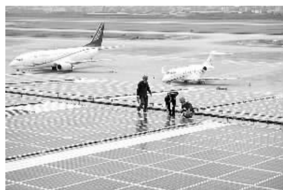
6月21日,技术人员在杭州萧山国际机场货站屋面对分布式光伏发电项目进行巡检。当日,位于杭州萧山国际机场货站屋面的分布式光伏发电项目通过国家电网杭州市萧山区供电公司验收,顺利投产运行,并接入国家电网。新华社记者 黄宗摄
