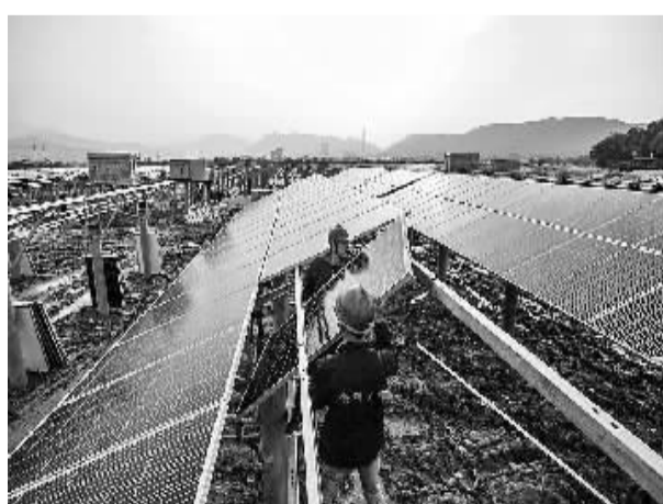
江西省新余市光伏发电项目总装机容量达425兆瓦，已并网发电总规模达153.16兆瓦。图为5月18日，工人在江西省新余市分宜县德佑光伏35兆瓦“渔光互补”光伏电站项目上施工。 本报记者 刘兴摄
