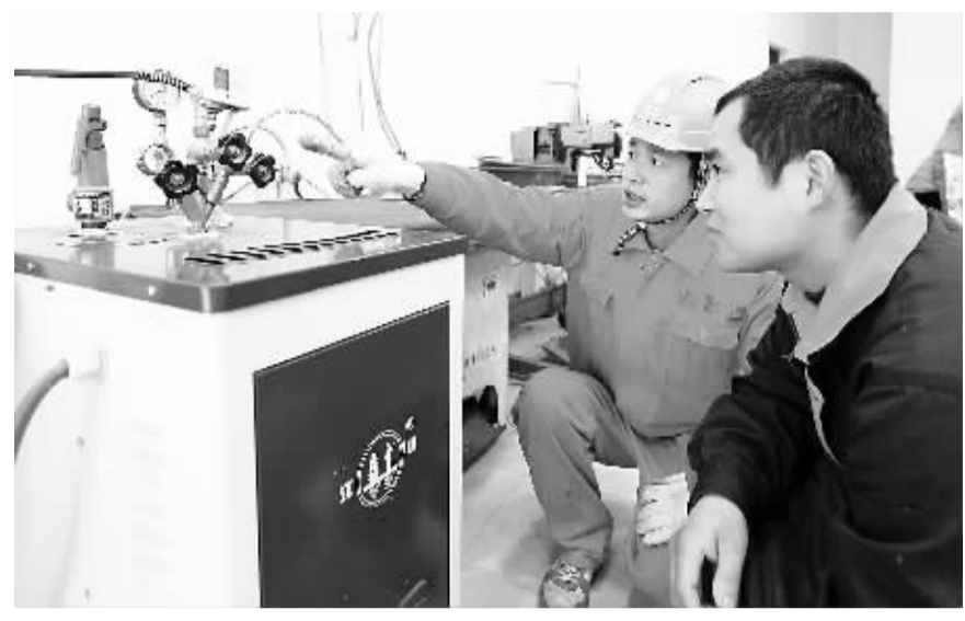
浙江湖州的电力服务人员正在帮助织里童装生产企业检查电锅炉运行情况。沈贺铭摄
