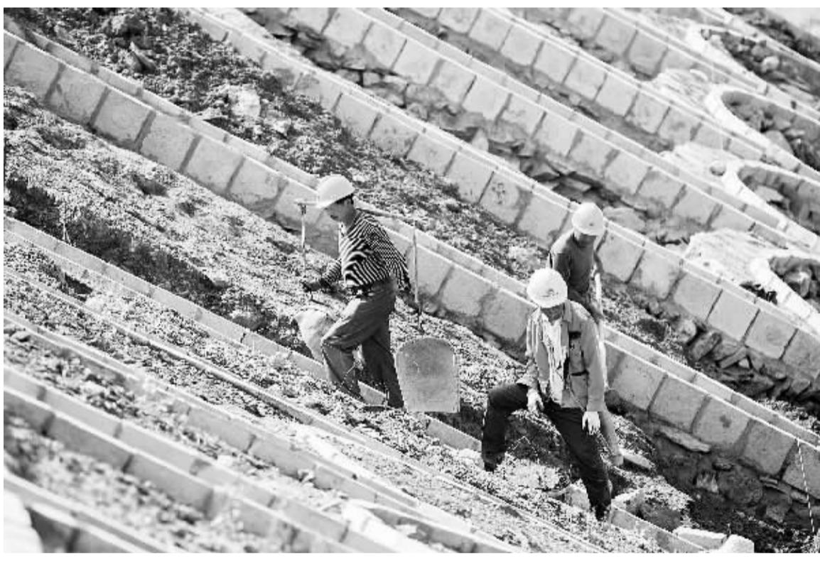
5月1日,中国铁建二十五局建设工人在九景衢铁路都昌站护坡施工。节日期间,许多劳动者坚守在九景衢铁路建设一线。傅建斌摄
