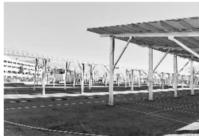
图为安装在巴基斯坦议会停车区域的光伏板。
