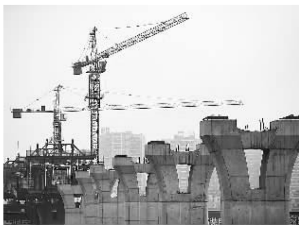
这是2月2日在成都市双流区境内拍摄的正在建设的铁路桥。目前,四川成(都)蒲(江)铁路线正加紧建设。成蒲铁路起于成都西站,经双流、温江、崇州、大邑、邛崃至蒲江县朝阳湖镇,全线路正线里程98.678公里,设计速度每小时200公里。
