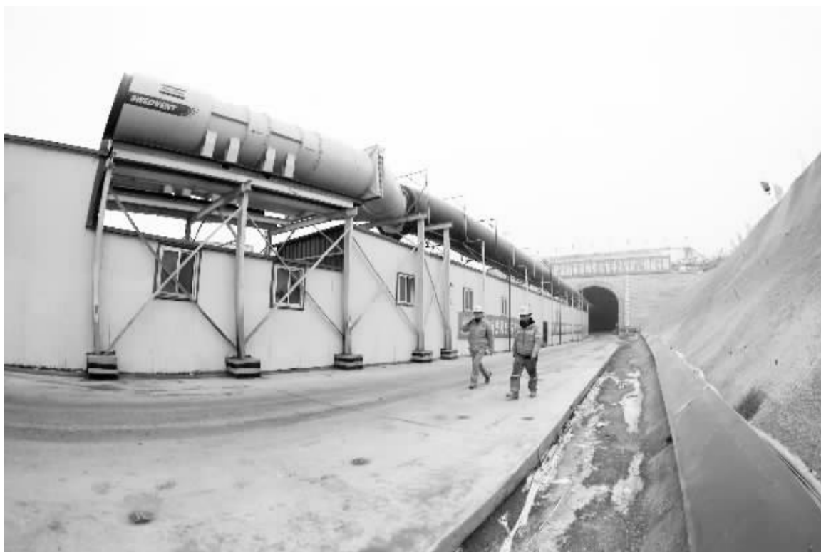
2015年12月22日拍摄的采用盾构机施工贯通的神华神东补连塔矿2号副井井口。当日,我国第一座采用全断面隧道掘进机(又称盾构机)施工的煤矿斜井——神华神东补连塔矿2号副井顺利贯通,这标志着我国矿用斜井设计施工与装备技术达到世界先进水平。
