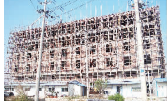
图为该违法建筑已经建到第七层。
