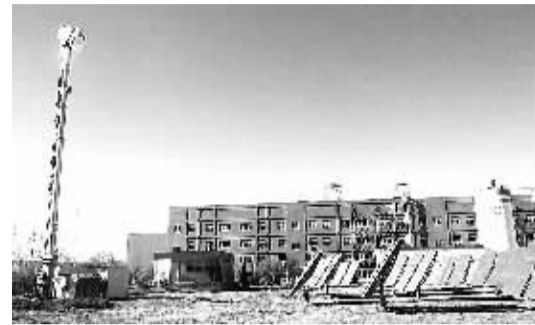
塔式聚光光伏系统示范项目现场。马洪超摄
