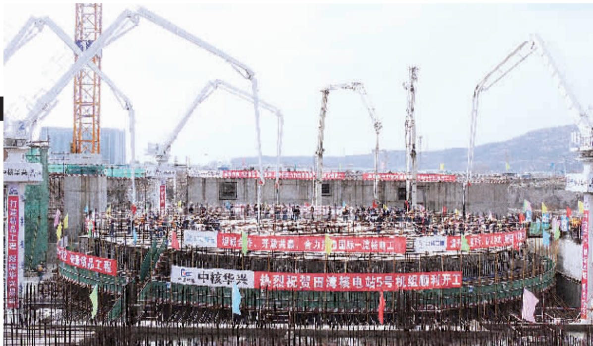
12月27日,江苏连云港田湾核电站扩建工程5号机组施工现场,工人正在浇筑核岛底板混凝土。当日,中核集团田湾核电站三期扩建工程5号机组正式开工建设。田湾核电站三期扩建工程5、6号机组是江苏省“十三五”期间重大投资建设项目,85%实现国产化,投产后每年可向华东电网送电约147亿千瓦时。
