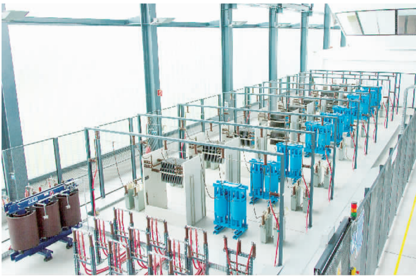
图为德国尤尼克斯公司技术中心内的电池存储系统。
