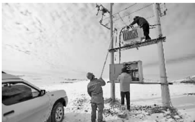
11月22日,国家电网张家口供电公司电力工人对配电设备进行抢修。武峰摄(新华社发)
