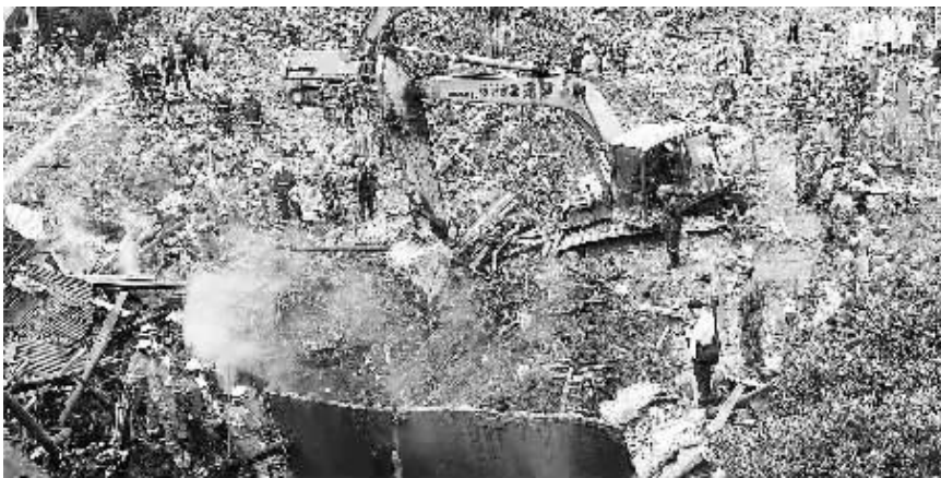
11月14日拍摄的浙江丽水山体滑坡救援现场。
