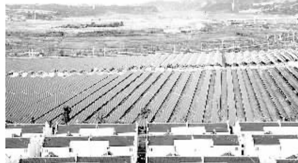
8月11日,湖北十堰市郧阳区柳陂镇40兆瓦光伏电站项目并网发电。该项目规划面积1400亩,总投资3.53亿元,是丹江口库区装机容量最大的光伏发电项目,预计年发电4300万余千瓦时,可实现年收入2.3亿元。程毓华摄
