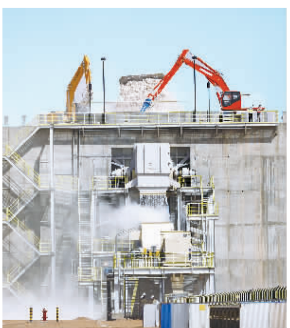
图为沙特磷矿选矿厂。 本报记者 王俊鹏摄
