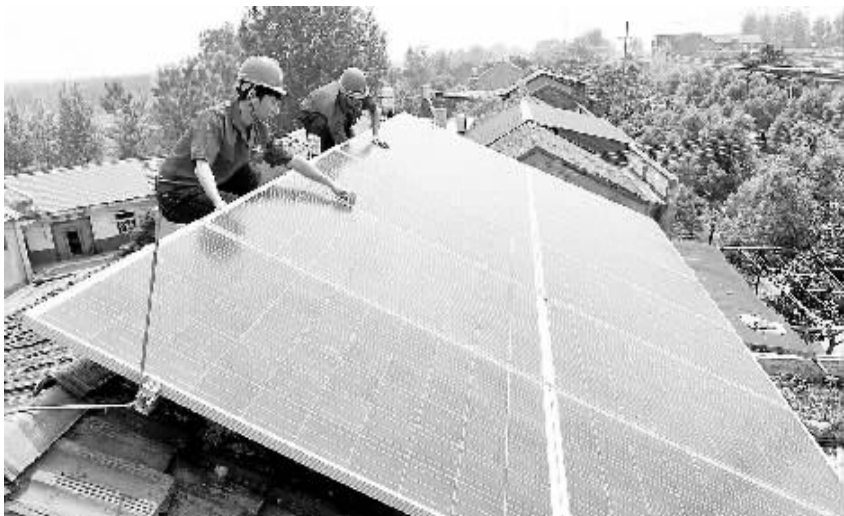
4月29日,在肥西县山南镇金牛社区,工作人员在为一户残疾人家庭安装光伏设备。为提高农村贫困残疾人家庭收入,安徽省肥西县投资60万元,为山南镇、高店乡20户贫困残疾人家庭免费安装3kW小型户用光伏电站。
