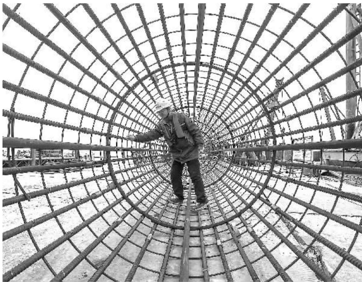
3月20日，平潭海峡公铁两用跨海大桥的工人在制作钢筋笼。平潭海峡公铁两用跨海大桥为钢桁结合梁斜拉桥，自2013年11月动工建设，起于福建省长乐市松下镇，经人屿岛、长屿岛、小练岛、大练岛，到平潭岛。 新华社记者 程敏摄
