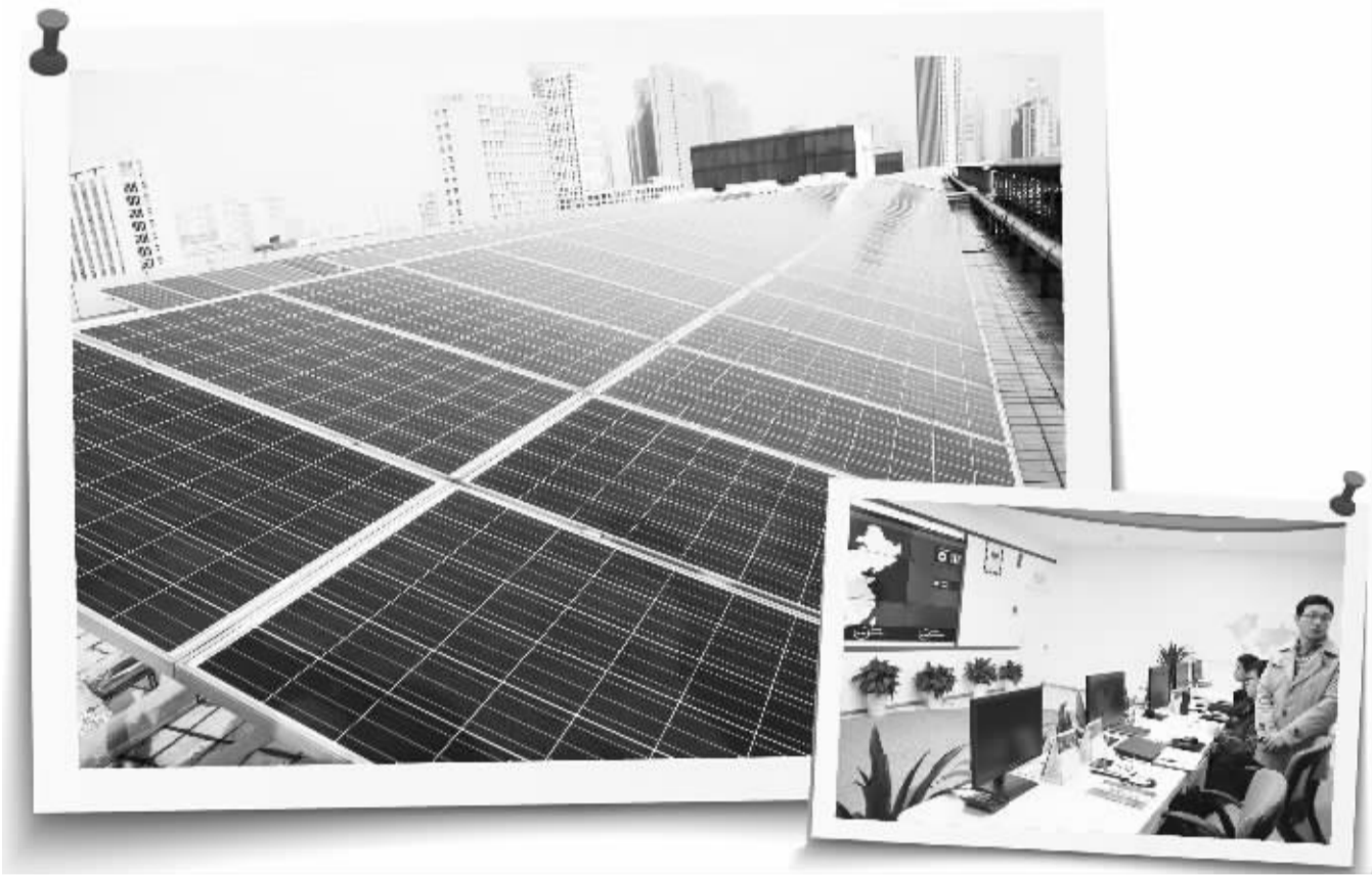
左图 位于合肥市高新区的阳光电源股份有限公司在自家厂房上建起了屋顶光伏电站。本报记者 杨国民摄
