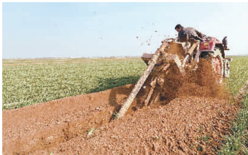
3月12日,村民在河北省永年县讲武乡小北汪村进行“小农水”施工。
