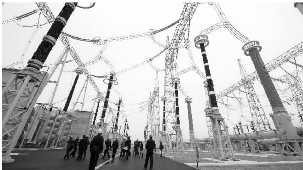
2014年底，福建省首个特高压变电站——特高压榕城站正式投入使用。
