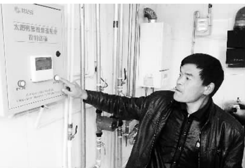
图为河北固安南王起营村村民王庆在调试自家的太阳能供热设备。本报记者 常理摄
