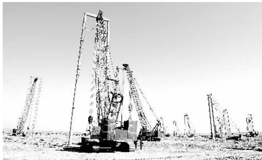
11月4日,大型机械在山东—浙江特高压直流输电工程现场施工。该工程是国家确定的大气污染防治行动计划12条重点输电通道之一。新华社记者 王鹏摄
