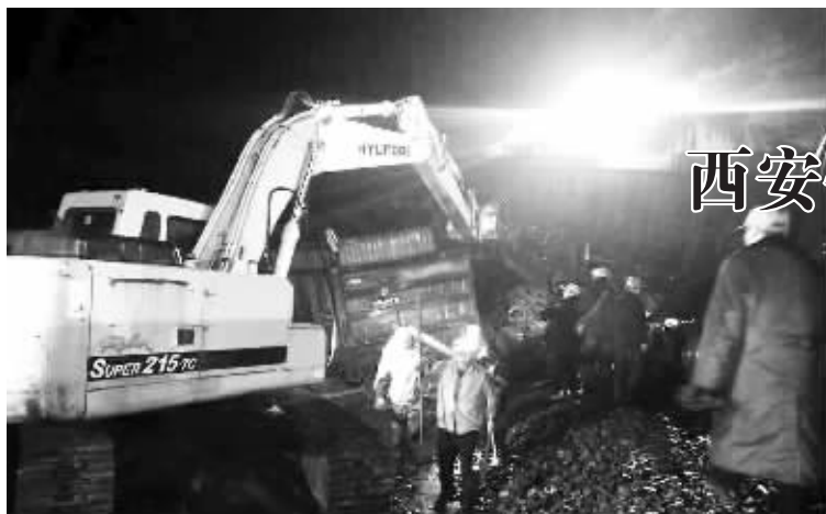
图为11月24日晚的襄渝铁路抢修现场。（西安铁路局供图）
