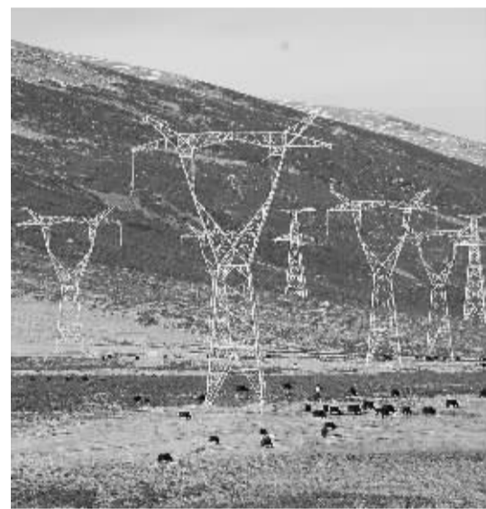
川藏电力联网工程是世界上最具建设挑战性的输变电工程,图为川藏联网工程西藏昌都地区输电线路。 郭往摄
