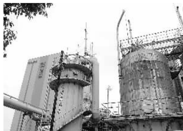
钢铁循环产业链是北仑“产业中循环”的一个缩影。宁波宝新不锈钢把宁波钢铁的焦炉煤气净化后替代天然气使用，每年能节省生产成本1000万元。
