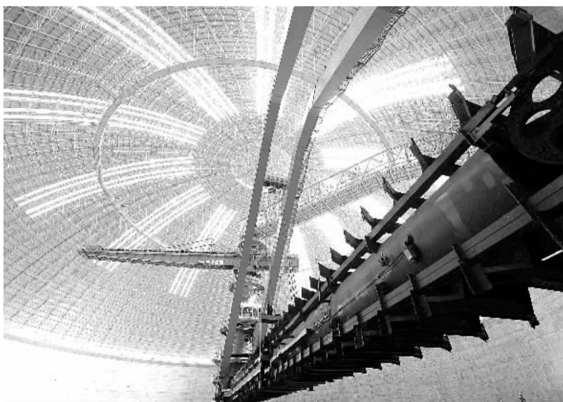
10月23日,位于陕西榆林的充矿榆林100万吨/年煤间接制油示范项目,进入设备安装调试阶段,该项目是国家“十二五”煤炭深加工示范项目,具有自主知识产权的核心技术,在国内处于领先水平,预计明年5月正式投产运行。图为大型储煤仓的设备正在调试中。
