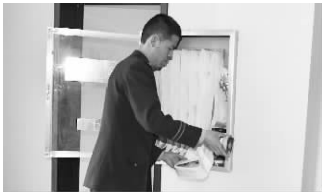
图为甘肃卓尼公安消防大队消防人员正在检查辖区单位的消火栓。唐绍鹏摄
