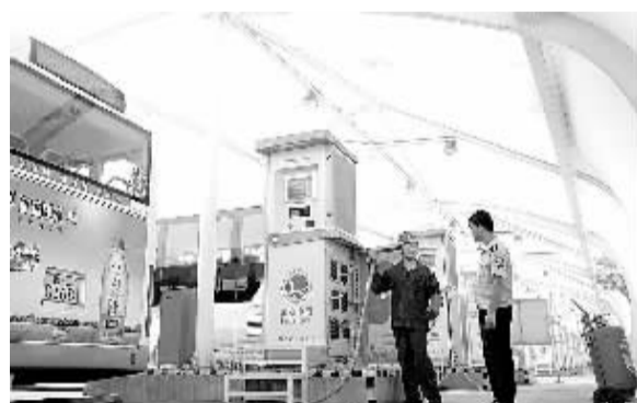
7月5日,山东日照供电公司员工在日照万平口电动汽车充电站为电动公交车充电。截至目前,日照新能源公交车已达290辆,占到全市公交车总数的一半以上。
