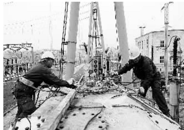
工作人员在位于黑龙江省鸡西市的220千伏梨树变电站作业。为提高地区供电可靠性,黑龙江鸡西供电公司首次利用变电站人员重组优势,采取运检合一的工作方式进行联合作业。 本报记者 赵晶摄
