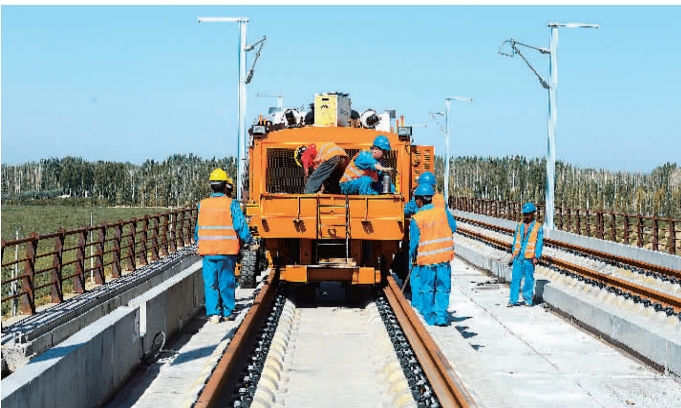
在新疆哈密市郊,中铁一局的施工人员在兰新铁路第二双线新疆段无缝长钢轨铺设现场作业。 新华社记者 赵 戈 摄
