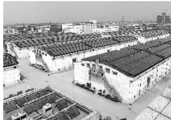
江苏常州城北国家粮食储备库在17幢仓库屋顶安装了2.55兆瓦容量的分布式光伏电站,并于2013年12月并网发电,截至目前累计发电近27万千瓦时。图为屋顶的光伏电站。 孙宇摄(新华社发)
