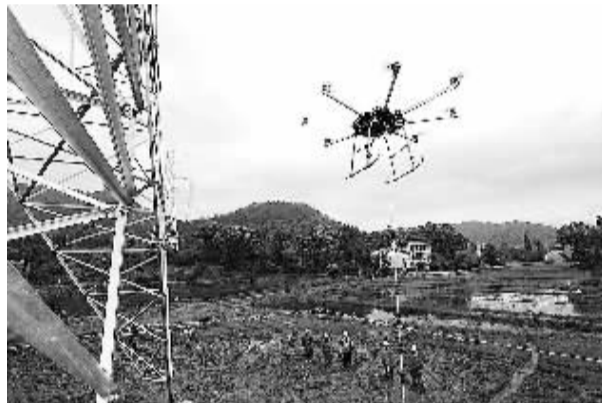
图为多旋翼无人机带着牵引拉线升空。近日，在浙江诸暨凤仪到枫桥的220千伏电力线路施工中，国网绍兴供电公司使用多旋翼飞机进行放线。这是浙江首次使用多旋翼飞机开展架设高压线路作业。 新华社记者 韩传号摄
