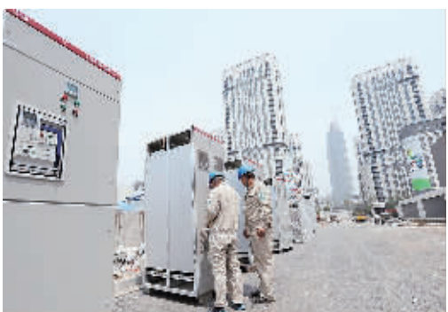
5月8日，国网南京供电公司技术人员在青奥会对安装的用电设备进行检查。当日，南京青奥会迎来倒计时100天，青奥村正式通电。
