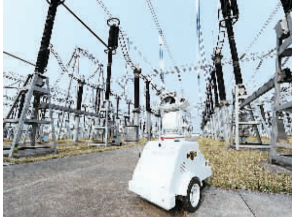
2月23日,智能巡检机器人在无锡500千伏斗山变电站运行。当日,无锡500千伏斗山变电站智能巡检机器人正式投入使用。潘正光摄(新华社发)
