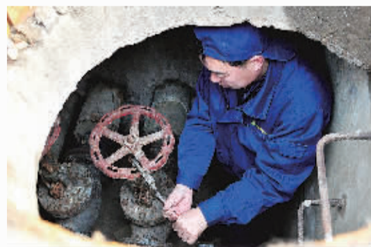
维修工孙海军正在进行设备巡检。
