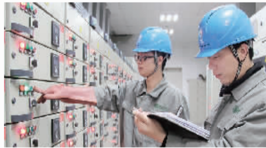
连日来,温州电力工作人员分头到机场、火车站等的配电室检查线路,确保供电安全。本报记者 张致撰
