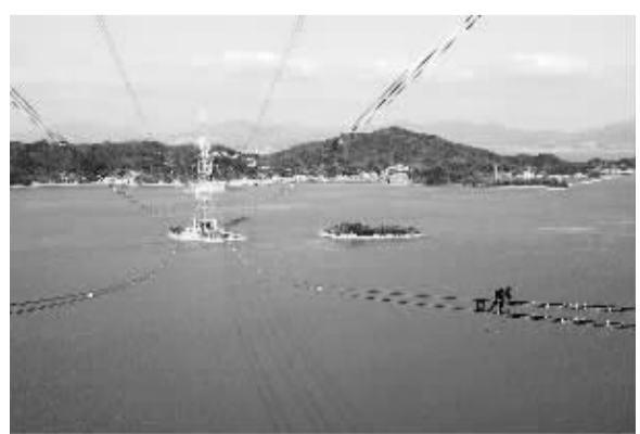
从1月14日开始，舟山六横电厂至宁波春晓（浦东）500千伏送出线路工程开始走线验收。该线路全长约36.5公里，为国内首条500千伏跨海输电线路。线路投运后，将为当地新区建设提供强有力的用电保障。图为电力工人正在进行走线验收。姚峰摄（新华社发）
