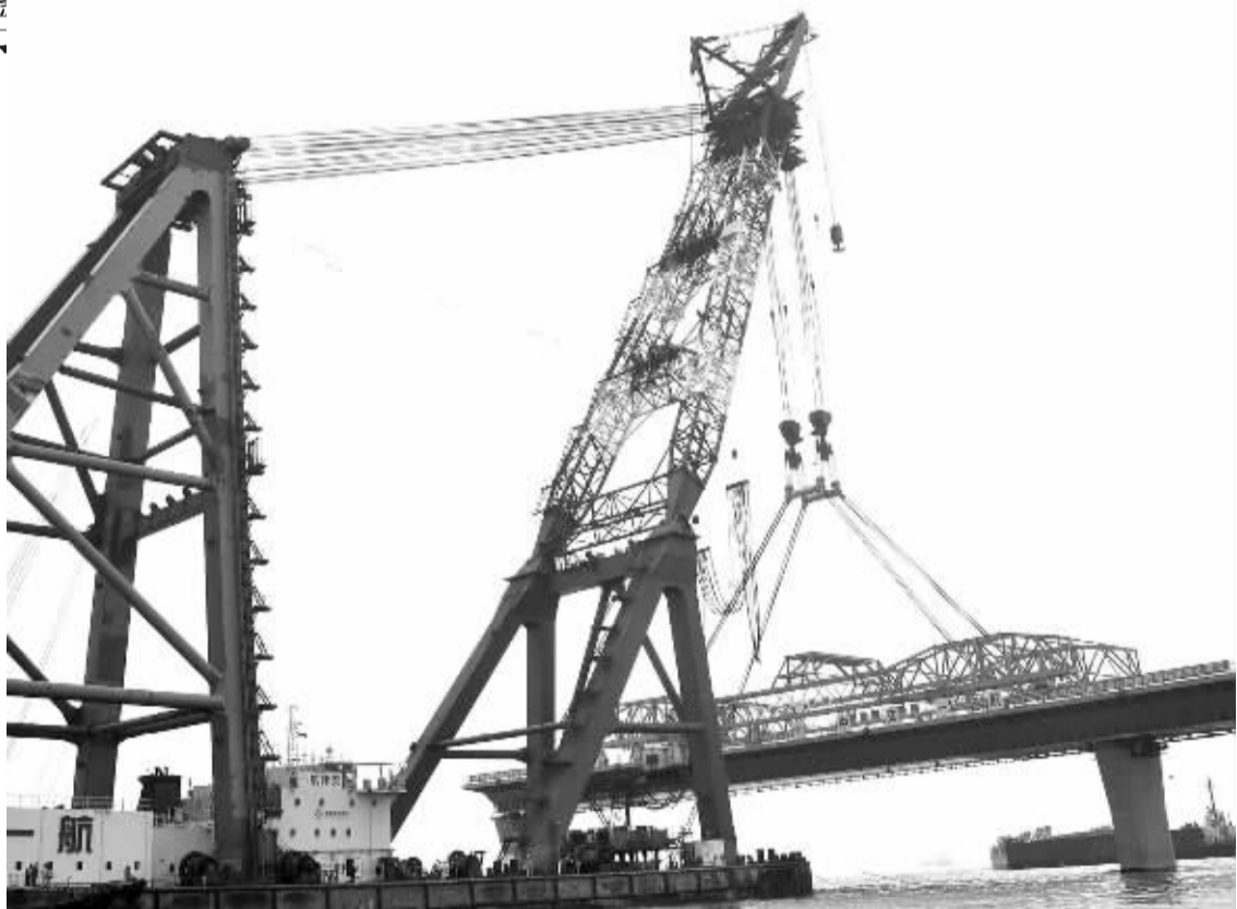
这是已安装于港珠澳大桥西人工岛附近深水区非通航孔桥香港侧第二联墩台的首跨钢箱梁(1月19日摄)。 1月19日,长132.6米、宽33.1米、高4.5米、重2815吨的港珠澳大桥首跨钢箱梁在深水区成功架设。这标志着该桥主体工程建设和取得了一个阶段性突破。 新华社记者 魏蒙摄
