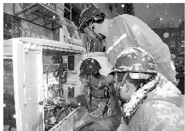
山东省威海市积极实施“暖冬”工程,对尚未集中供暖的小区推广电采暖,截至目前已先后对11个社区实施了电力设施升级改造。图为国网威海供电公司员工冒雪对电力设施进行维护。 本报记者 徐克强摄
