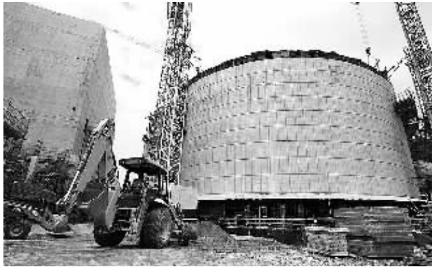
11月18日,在巴西里约热内卢,工人在安格拉核电站三期工程建设工地施工。安格拉核电站是巴西目前唯一的核能发电站。
