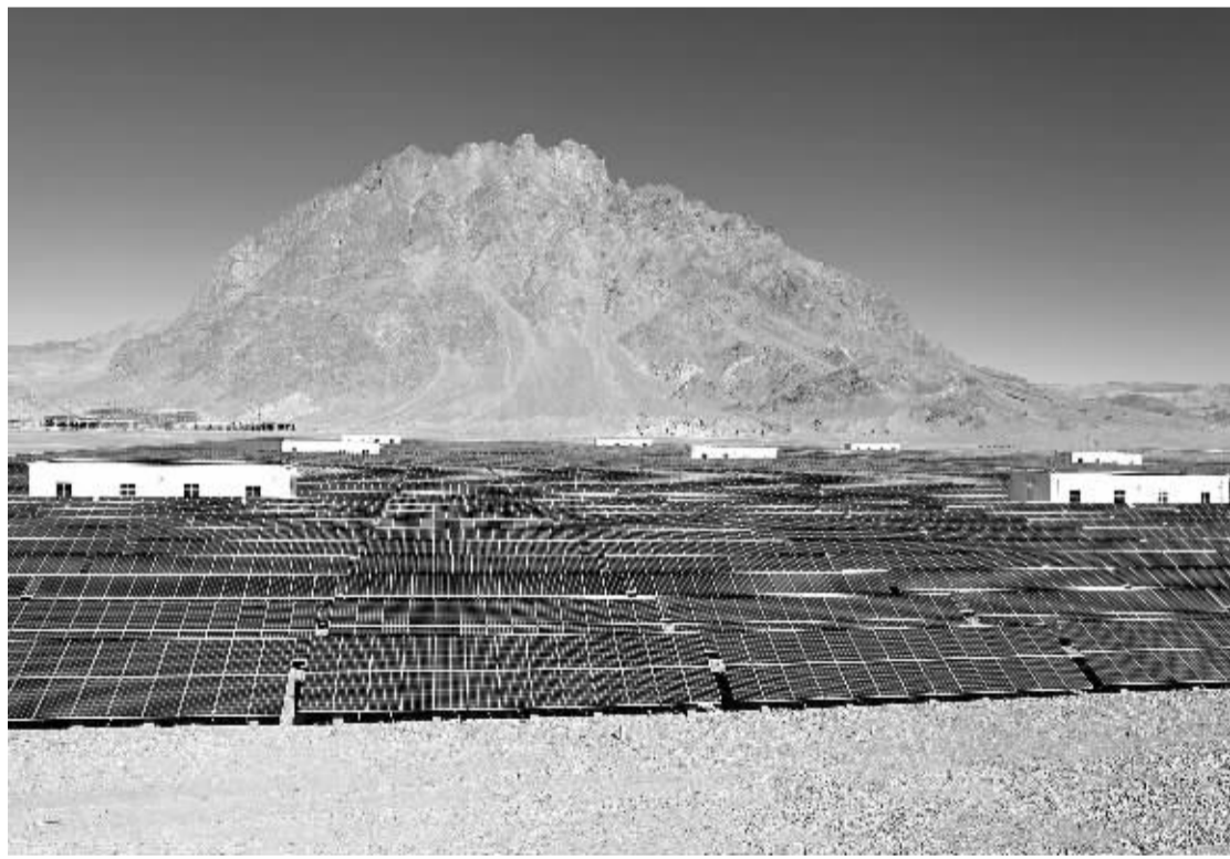
11月26日拍摄的西藏阿里光伏电站。近日,我国海拔最高的10兆瓦级光伏电站——西藏阿里光伏电站,完成二期5兆瓦装机容量工程...
