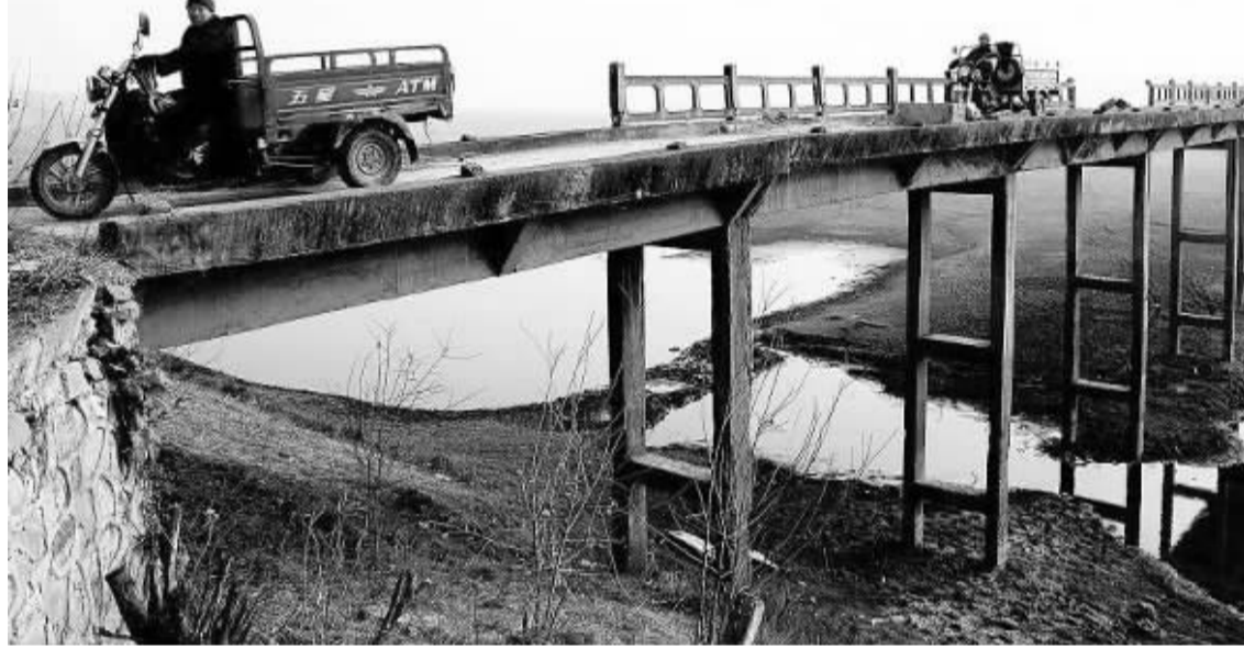
武汉市新洲区辛冲镇胜利湖村大桥破损，农用车、摩托车依然通行，存在较为严重的安全隐患。
