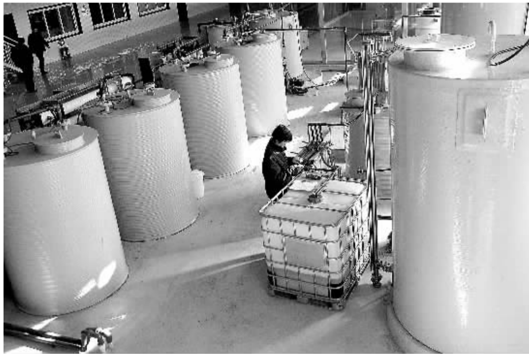
图为河北承德市万利通锂电池电解液制备车间(11月23日摄)。近日,万利通集团锂电池项目通过科技部中期检查,这标志着该集团在国家级研究课题中取得了阶段性进展。
