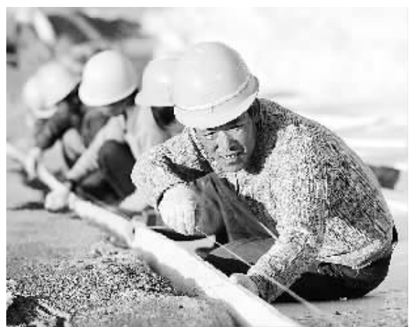
11月17日,工作人员在南水北调中线高长三标工地施工。该项目由中国水电基础局承建,是中线唯一穿越大型煤矿采空区的项目。 本报记者 赵晶摄
