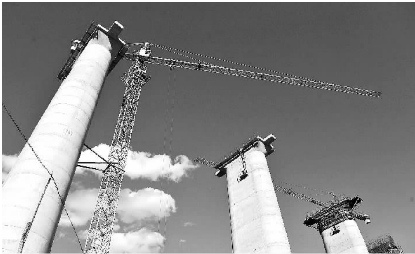
11月12日,施工人员参加云南广通至大理铁路扩能改造工程的沙桥楚大高速立交双线特大桥建设。目前,泛亚铁路西线重要组成部分云南广通至大理铁路扩能改造工程正在有序推进。工程全长174.59公里,设计时速200公里,工程概算投资总额为137.98亿元,预计于2017年完工。
