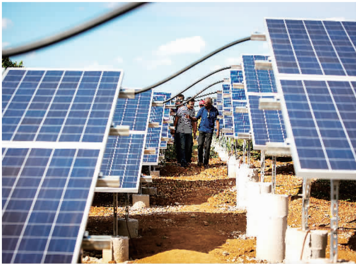
11月3日，中古双方施工人员在古巴首都哈瓦那市郊的展览中心园区的中国承建的光伏电站内工作。当日，由中国北京控股集团有限公司捐建的古巴1兆瓦光伏电站正式并网发电。新华社发
